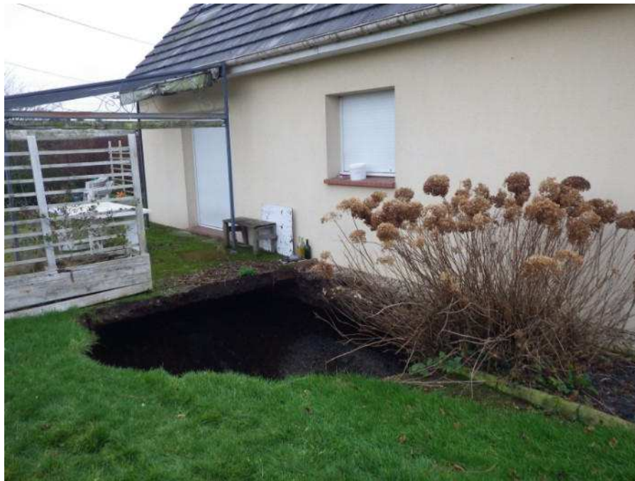
Effondrement d'une marnière à Saint Mards de Fresne (janvier 2018) © DDTM27/SPRAT/PR
